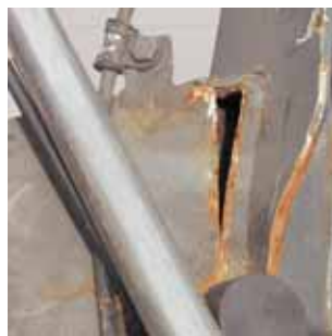
Rotura de la suspensión de la barra de acoplamiento, provocada por una catenaria deteriorada
